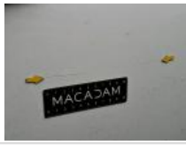
Montant de toit D, Bosse(s), LI - Réparer et peindre (complet)
