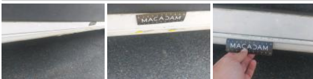
Moulure porte ARD, Griffe(s), Réparer/rempl. (montant forfaitaire)
