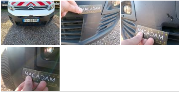
Bas de caisse ext D, Mauvaise réparation, Peindre
